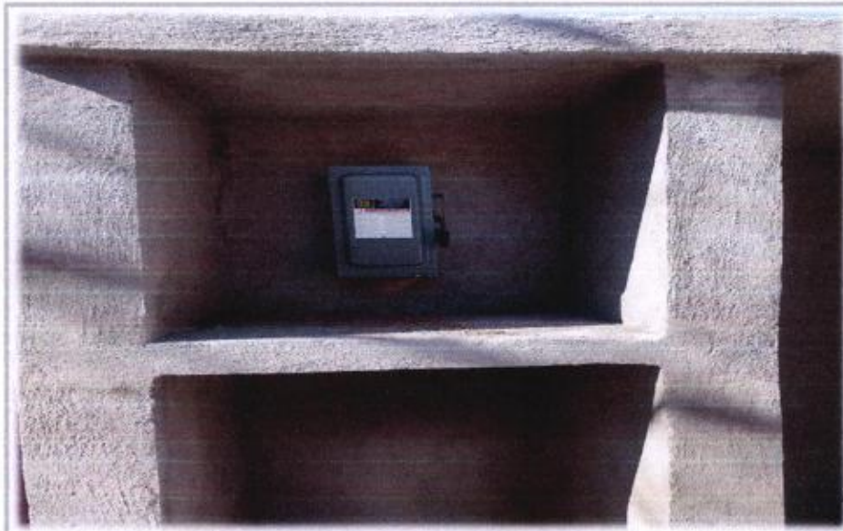
EQUIPAMIENTO DE POZO
